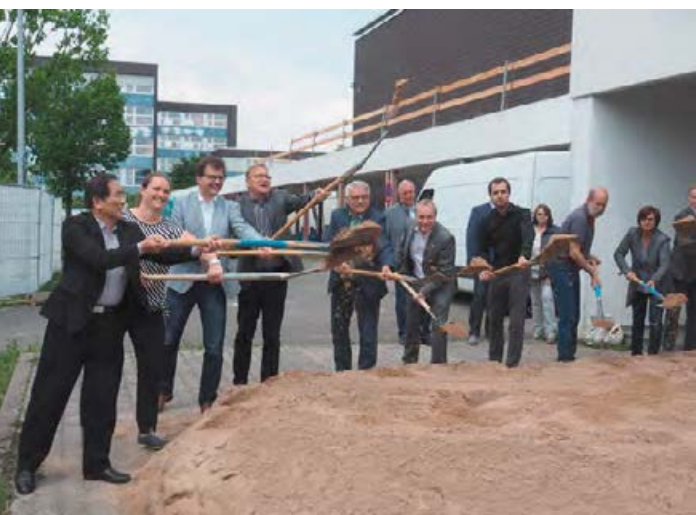
Spatenstich für ein Großprojekt: Die Sanierung der Graf-Stauffenberg-Dreifachsporthalle kann in Angriff genommen werden.
