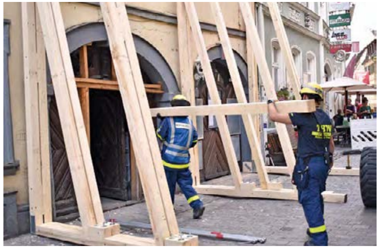
Im August musste das Einzeldenkmal Obere Sandstraße 20 vom Technischen Hilfswerk notgesichert werden.
